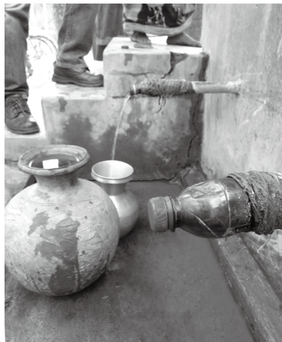
代替水源の蛇口はみんなが使うためよく壊れる。ローカルエンジニアのアイディアでペットボトルの蓋を採用。ローコスト（無料？）でメンテナンス。
